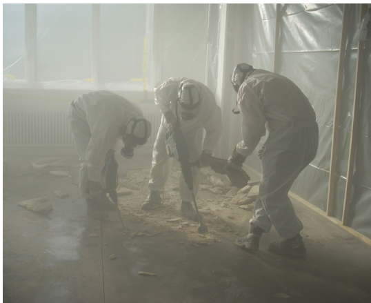
Oft finden sich in Immobilien, die vor 1990 erbaut worden sind, Schadstoffe in der Bausubstanz.
